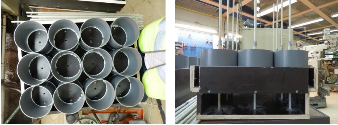
Figura 40 – Pormenor das caixas de cofragem e alinhamento dos varões no tubo de PVC
